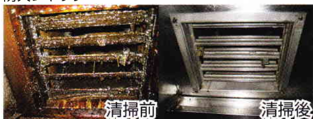
防火シャッター
